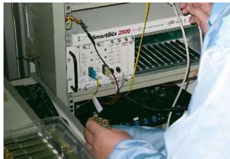
スマートビットによるエラーレート試験
